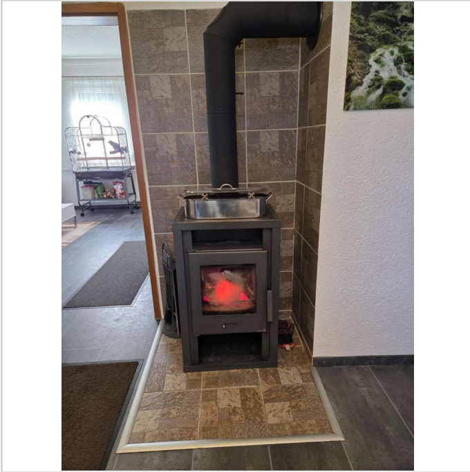
Holzofen Esszimmer OG
